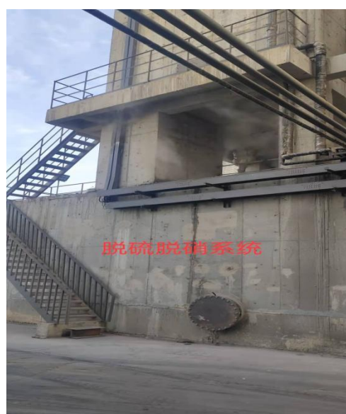
1F脱硝脱硝系统
